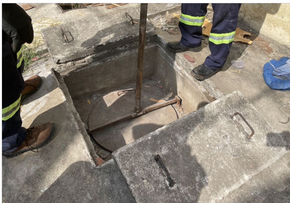
Foto 2 – Poço com tampa dupla de concreto
